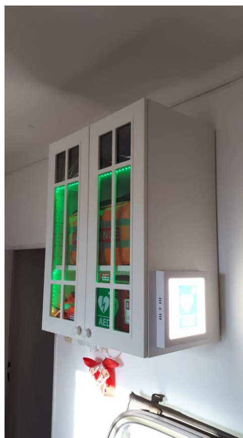
Obrázek 3: V případě sdělení kódu k otevření dveří se skříňka s defibrilátorem rozblíká zeleným světlem. Skříňka je umístěna na pravé stěně zbrojnice z pohledu od vchodu. Nalezení defibrilátoru by měla být otázka vteřin.
