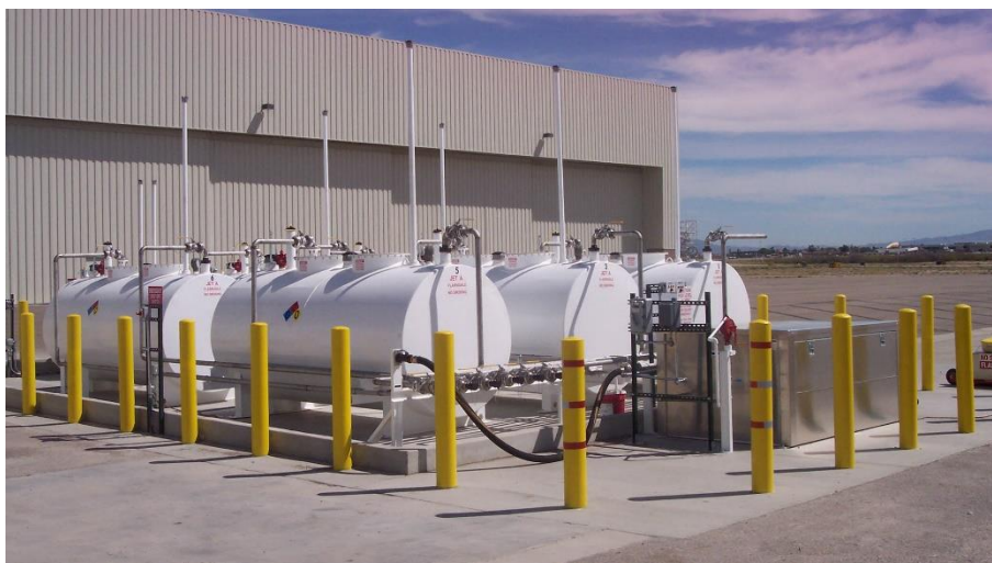
Obrázek 13 Stabilní cylindrické zásobníky pro venkovní skladování chloru [117]
