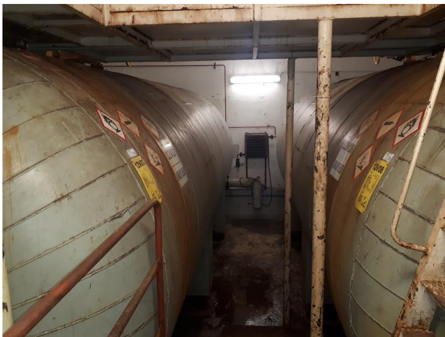
Obrázek 65 Dva zásobníky se skladovací kapacitou 55 tun kapalného chloru [zdroj vlastní].
