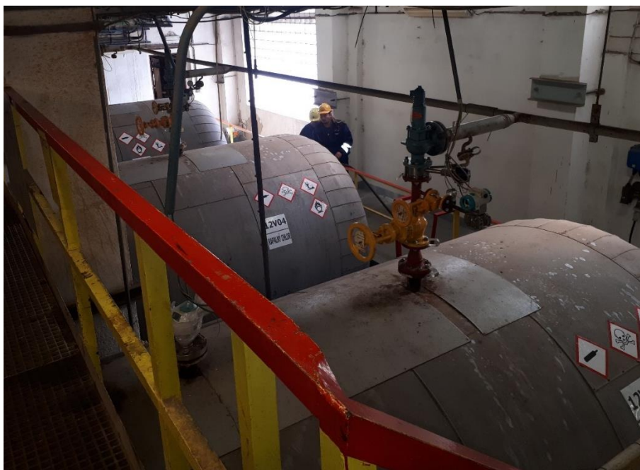
Obrázek 64 Tři zásobníky se skladovací kapacitou 65 tun kapalného chloru [zdroj vlastní].
